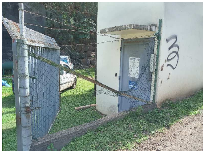
Exemple de clôture endommagée
