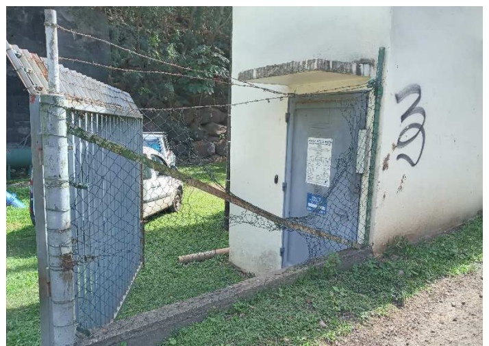
Exemple de clôture endommagée
